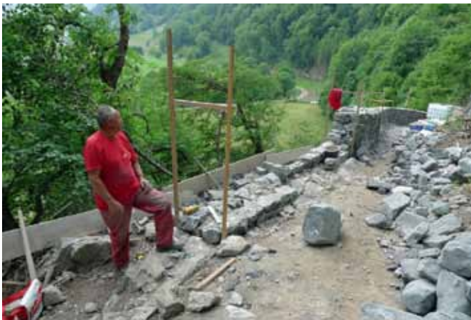
Der Maurer Faim Ajgeraj beim Wiederaufbau der Brüstungsmauer in der Hohwand. Bild Ralph Gantenbein, LG Bau AG
