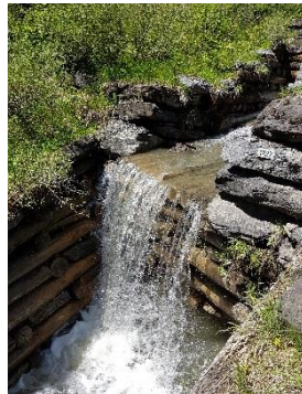
verschobenes Leitwerk bei Sperre 1237
