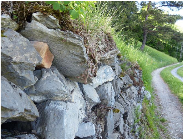
Mauer 280, Maienberg: Schlechter Zustand, ...
