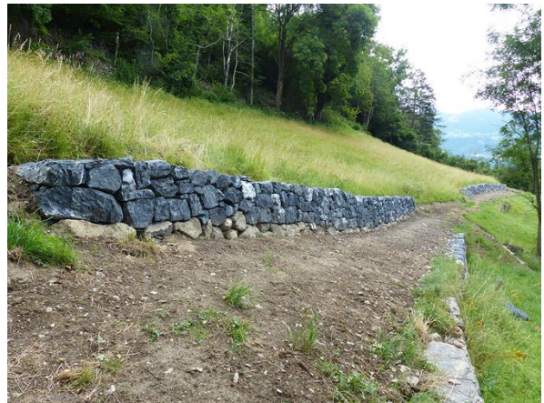
... und selbe Stelle nach der Instandstellung. Direkt oberhalb liegt eine Trockenwiese von regionaler Bedeutung (TW 286).
