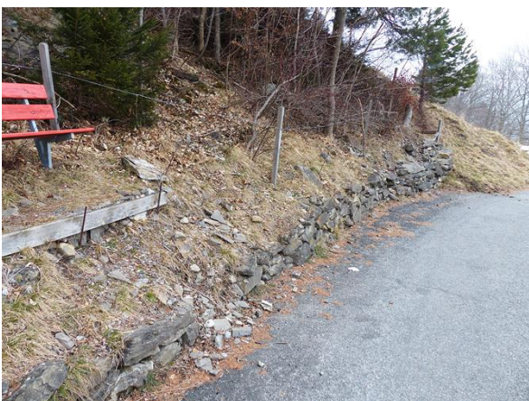
Mauer 264, Schneggenhag: Ausgangslage, zerfallend ...
