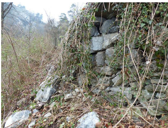
Mauer 131, Gässli: Zerfallende Mauerstelle ...
