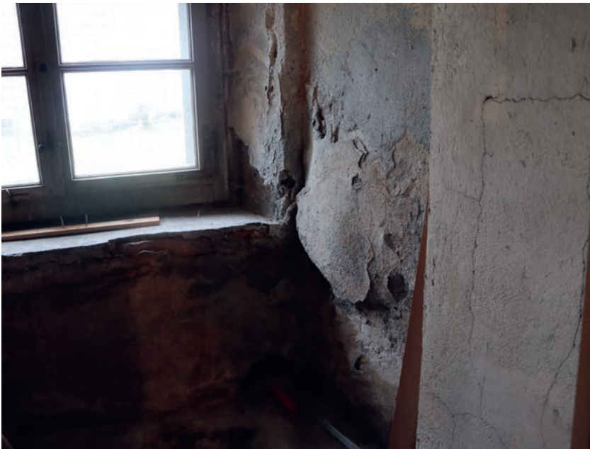
Abgeplatzter Verputz durch Feuchte im Kellergeschoss
