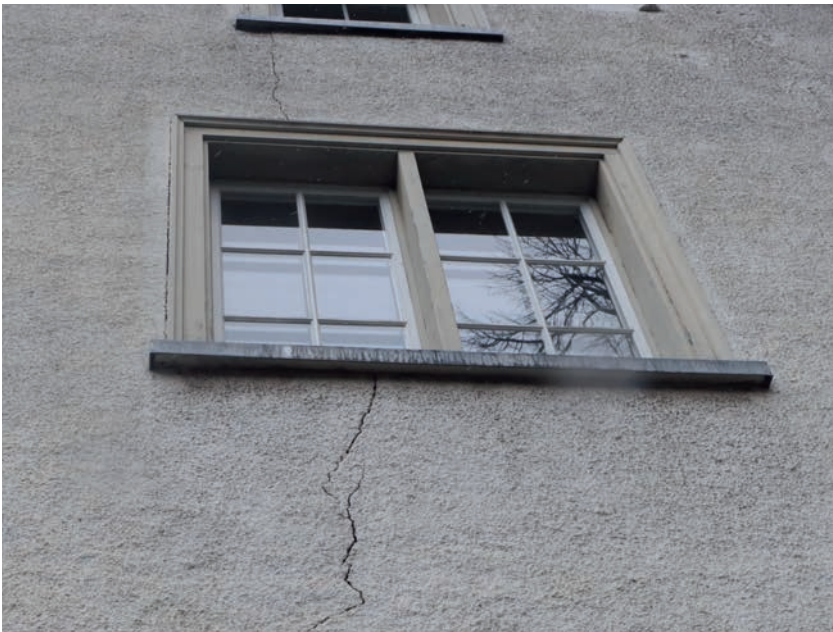
Risse in der Fassade
