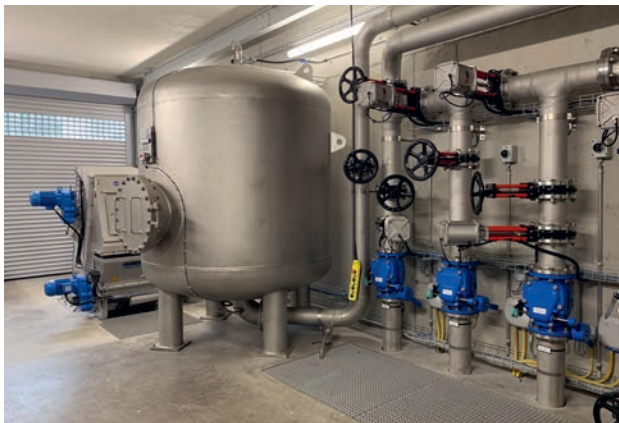
Pumpwerk Seidenbaum mit Druckschlagdämpfer
