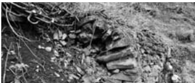
Bauchig, einstürzend und überwachsen: diese Mauer ist sanierungsbedürftig.
